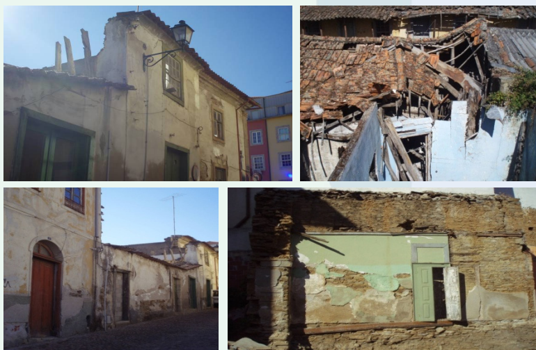
Mau estado de conservação de edifícios no centro histórico
