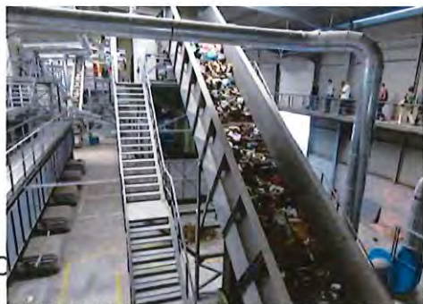
Figura 8– Linha de Alimentação da UTMB.
