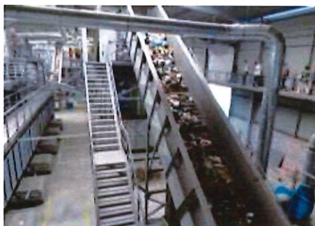
Figura 7– Linha de Alimentação da UTMB.
