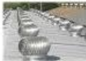
Sistema de Ventilação e Exaustão
