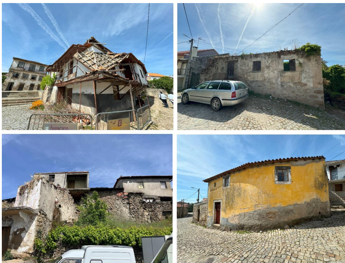
Figura 4. Exemplos de edificado degradado e/ou devoluto na ARU de Torre de Dona Chama
